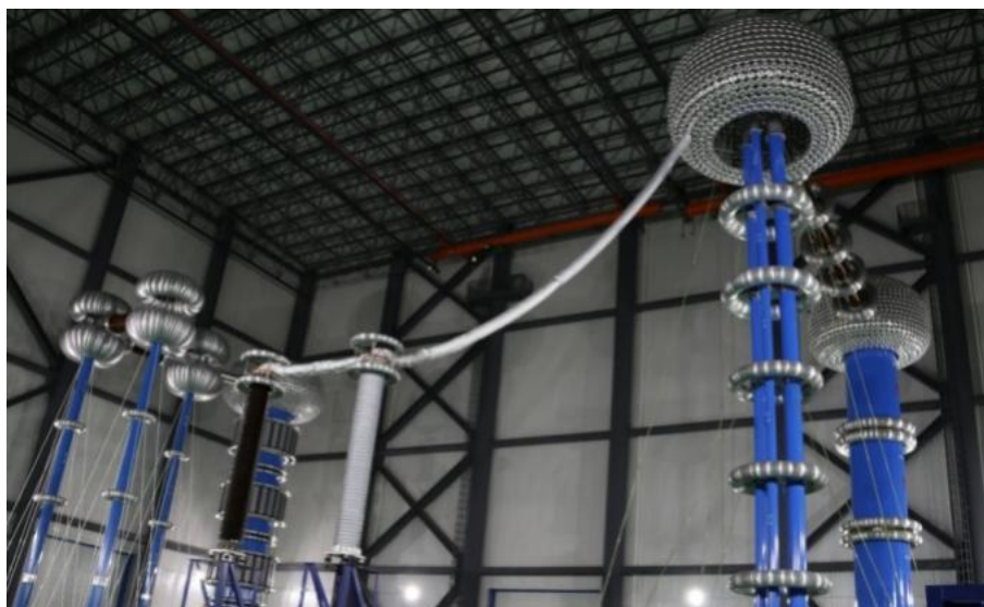
亨通超高压电力测试技术中心
