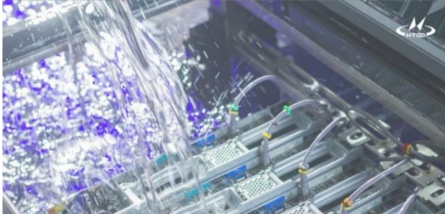
亨通浸没式液冷系统
