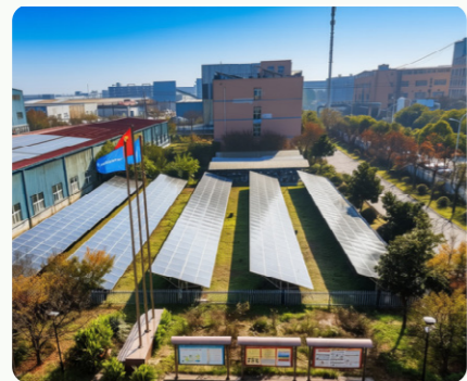
阜阳公司厂区分布式光伏发电项目
