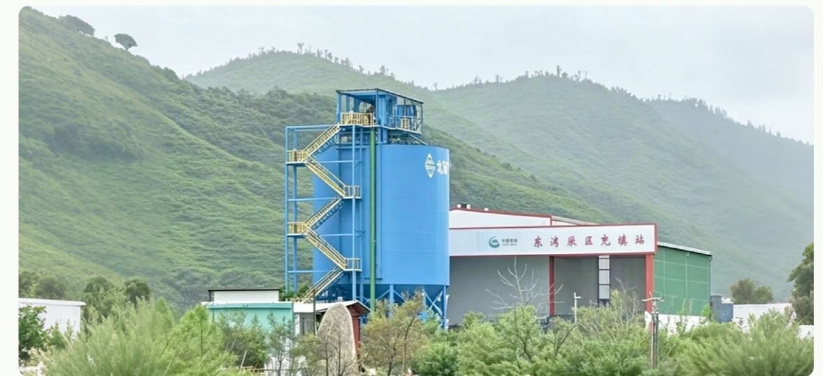
嵩县某金矿 | DCT-12 深锥膏体浓密机尾矿膏体回填应用
