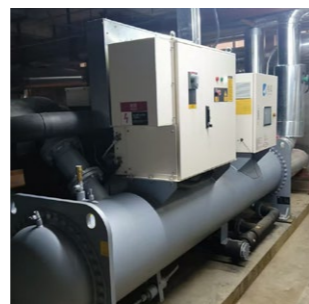
连云港金陵神州宾馆磁悬浮冷水机组改造
