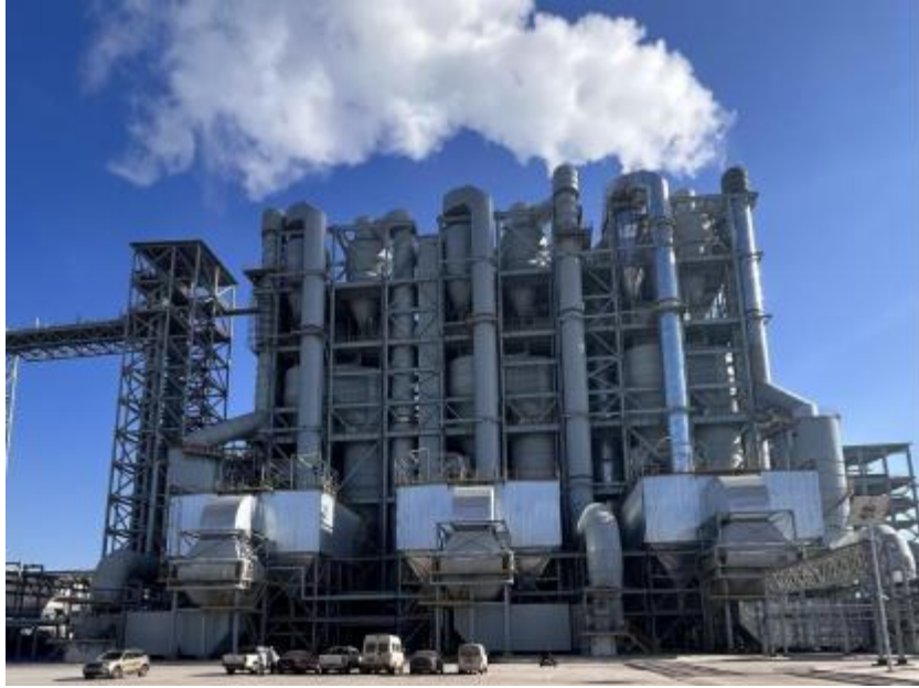
大型高效氧化铝气态悬浮焙烧炉
