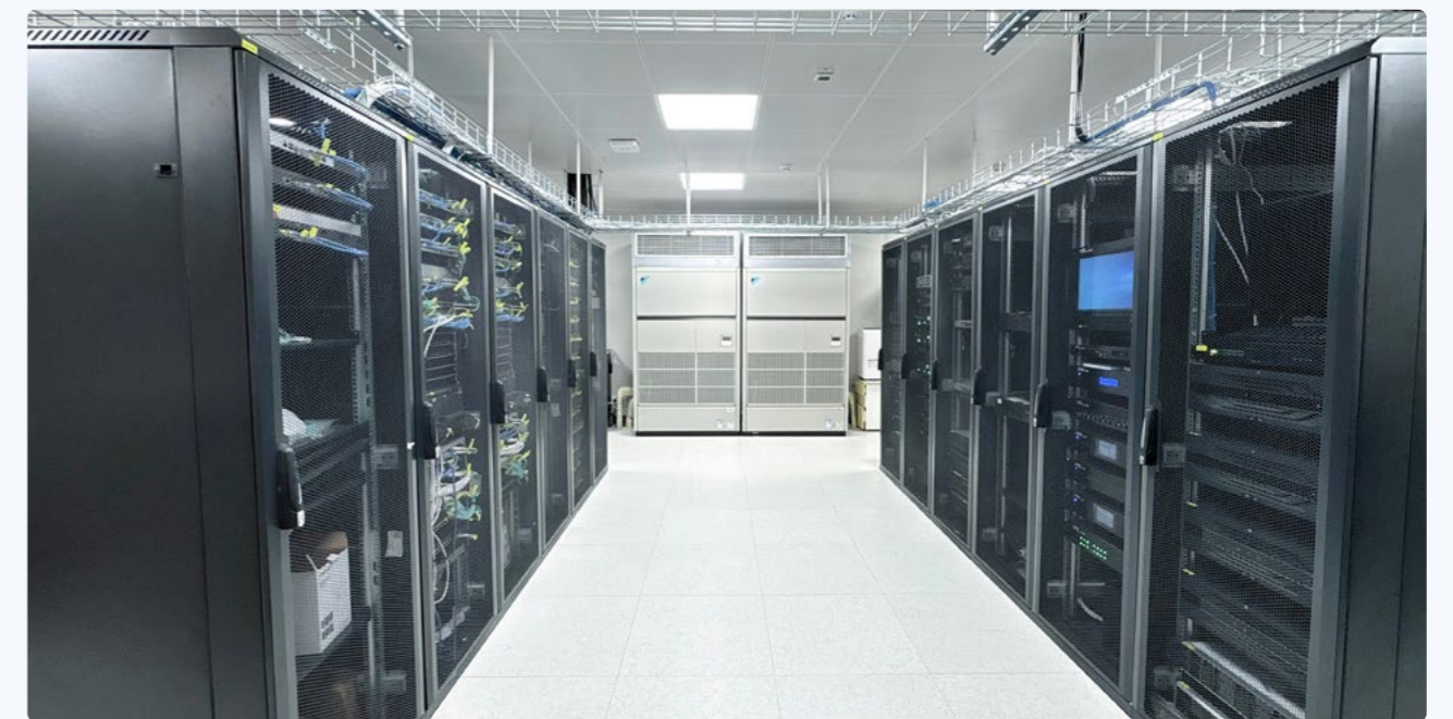
丸美大厦机房
