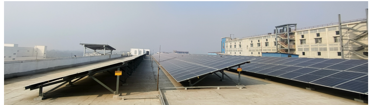
孟加拉国工厂太阳能光伏发电设施
