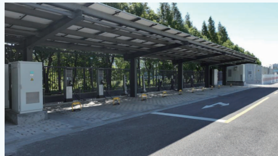
工业园区源网荷储一体化项目（V2G双向充电桩群智能调控）
