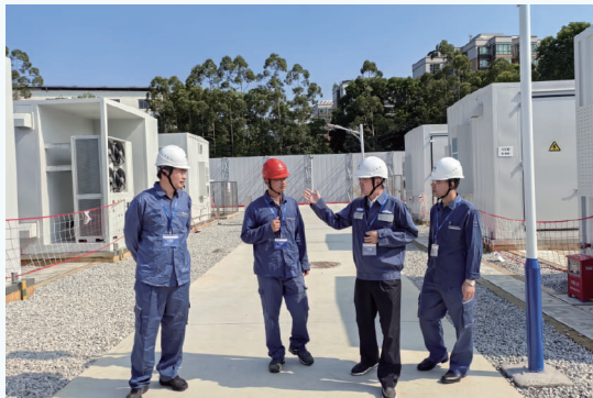
十五运供电储能工地检查指导
