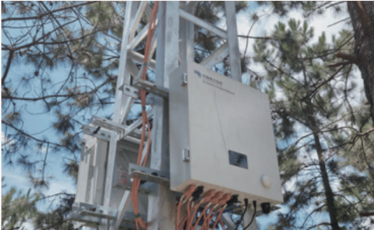
50kW碳化硅低压柔直调压装置挂网试运行
