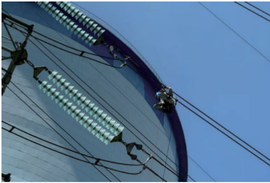
无人机+“小飞人”在广东电网公司韶关供电局220千伏雄墨线1号塔消缺作业中成功应用
