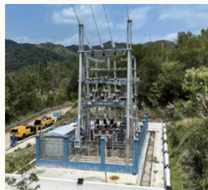
35KV简易配电站提升偏远地区供电能力
