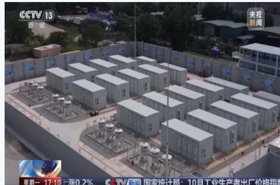
CCTV13《新闻直播间》报道十五运“市电与储能主供微电网”
