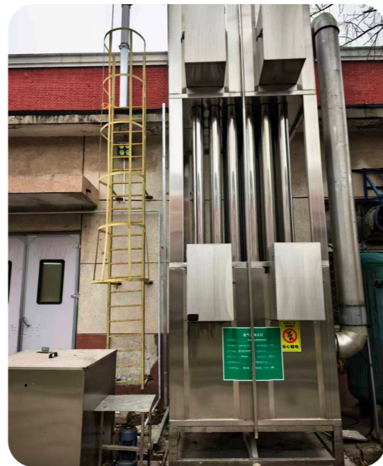
湿式静电除尘器
