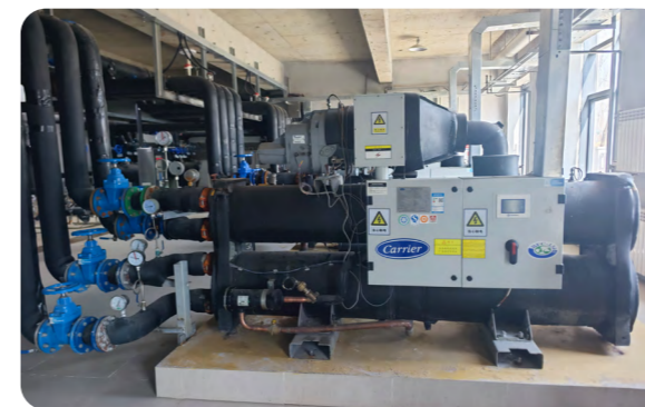
北京首创东坝水务污水源热泵系统
