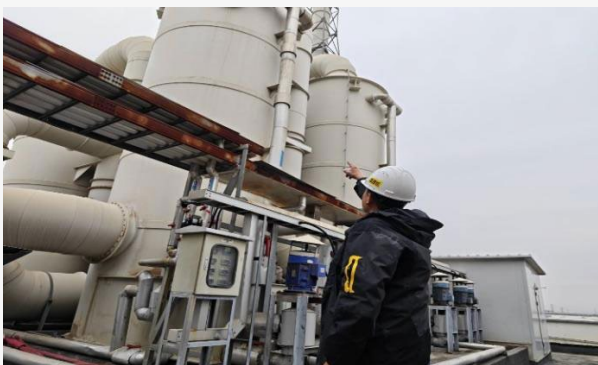
天津基地开展废气处理设施事故应急演练
