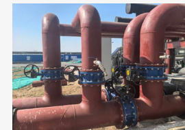
冰机系统自由冷项目装置
